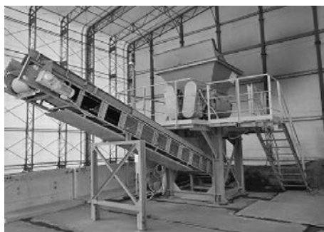
写真—10 焼却灰混合施設
