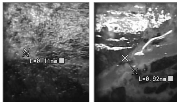
写真—11 ひび割れ幅の測定結果
