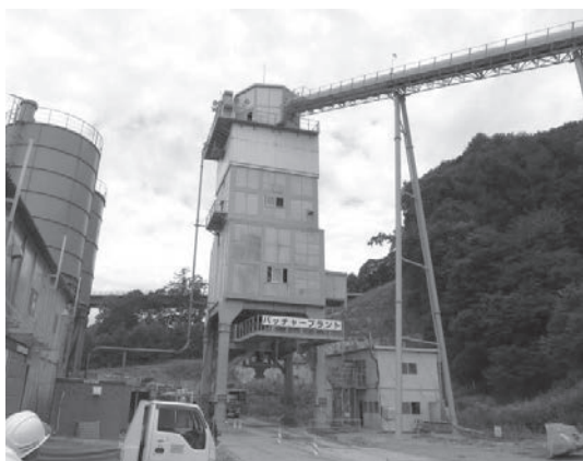
写真—3 コンクリート製造設備
