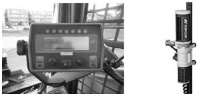
写真—5 制御装置とレーザ受光器
