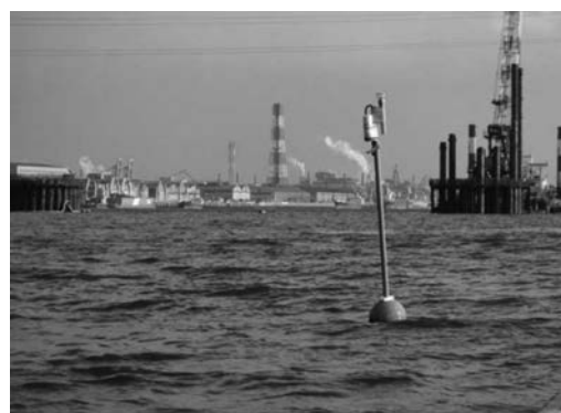
写真—4 通信制御装置の設置状況
