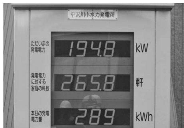
写真-8 発電出力パネル
