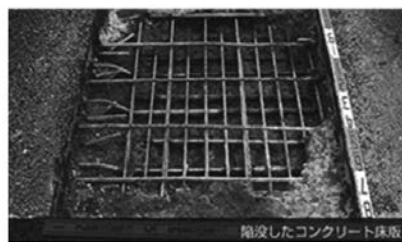
大型車等の影響による 床版の損傷
