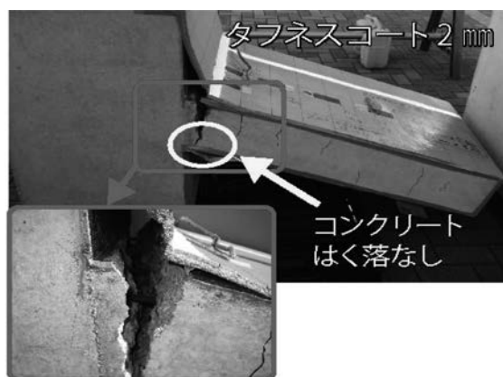
写真—3 RCT1-1 試験体の崩壊状況
