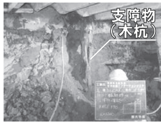
写真—9 支障物（木杭）
