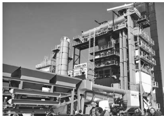
写真—20 骨材・コンクリートプラント
