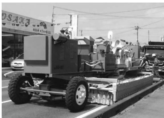
写真—3 路面ヒータ
