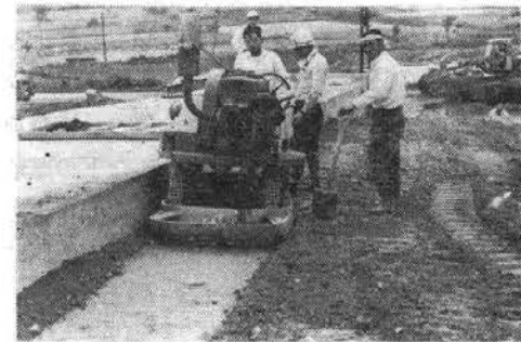
写真-3 ソイルコンパクタによる構造物裏込の締固め状況
