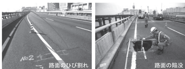
写真—2 鮫洲埋立部の損傷状況
