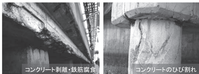
写真—1 東品川栈橋部の損傷状況
