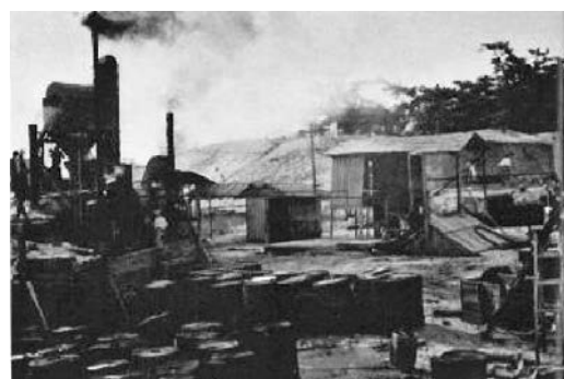
写真 2-24 瀝青混合物再生用プラント 千葉県姉ヶ崎～長浦間道路工事 (株)高野組)
