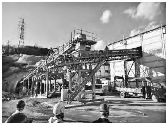
写真—10 連続ベルトコンベアシステム
