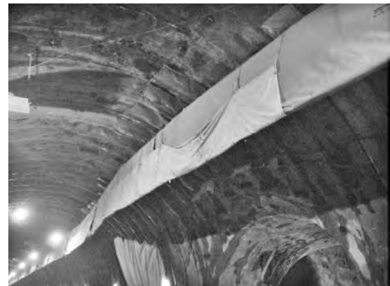
写真—6 風管に取付けた防爆シート
