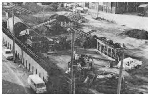
写真 4-2 リサイクルプラント全景
