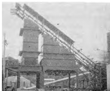
写真 4-14 合材貯蔵積出装置
