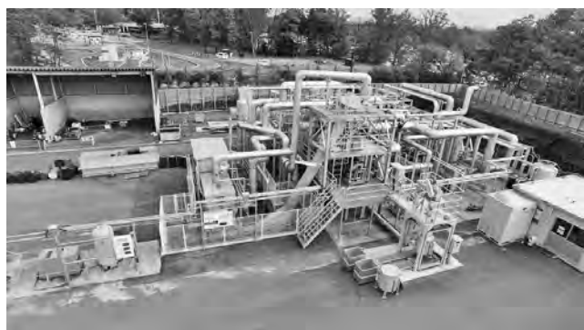
写真—1 那須バイオマスガス発電プラント
