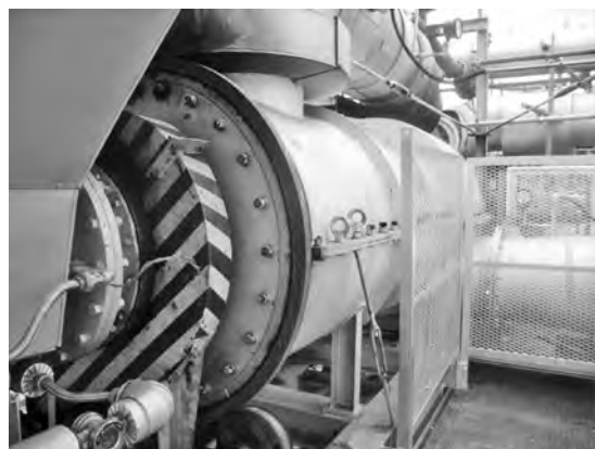
写真-3 熱分解炉 (U-ターンキルン)
