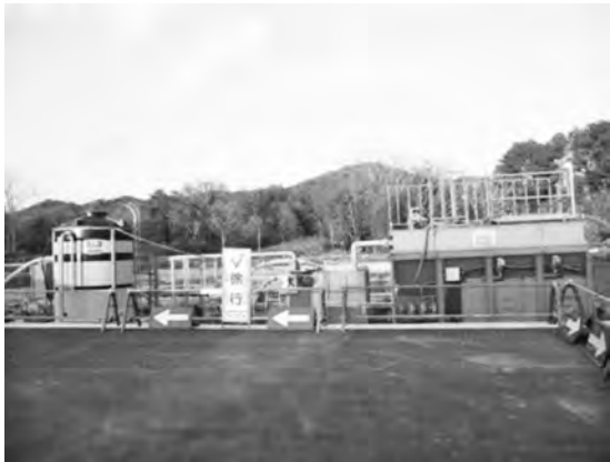
写真―5 ヒ素吸着設備
