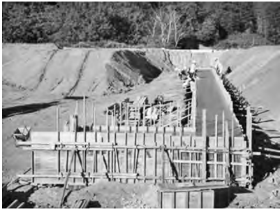
写真―4 雨水排水管
