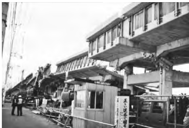
写真—1 兵庫県南部地震による山陽新幹線高架橋の被害例
