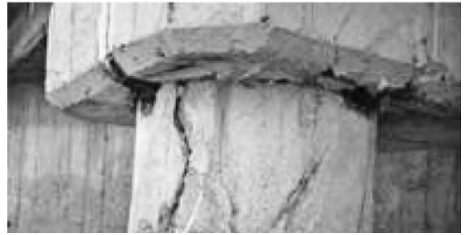
写真—2 交通インフラの老朽化
