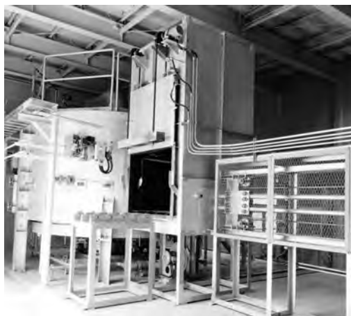
写真—2 焙焼実証設備の外観
