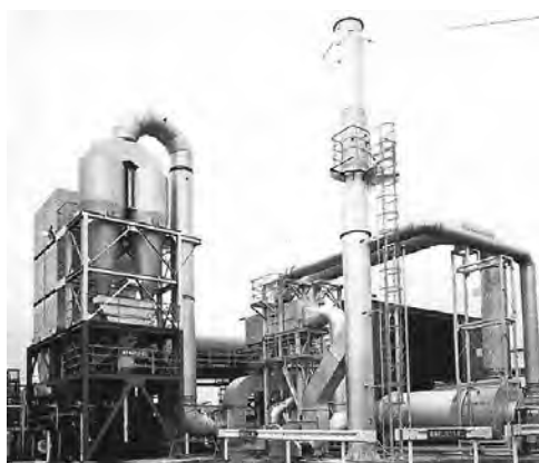
写真 5-11 脱臭炉方式リサイクルプラント
