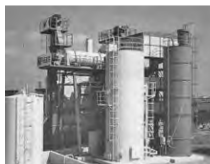
写真 6-8 再生アスファルトプラント SRP20T
