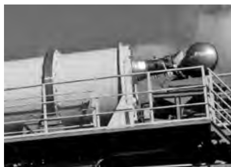
写真 6-20 ダイレクト加熱リサイクルプラント
