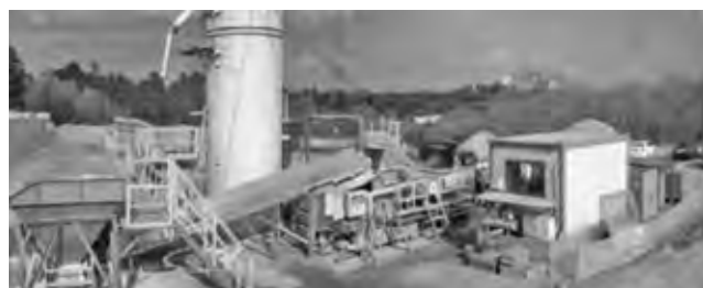
写真 6-22 定置型フォームドアスファルトプラント (成田市) (鹿島道路(株) 生産技術本部 阪田 正弘氏)
