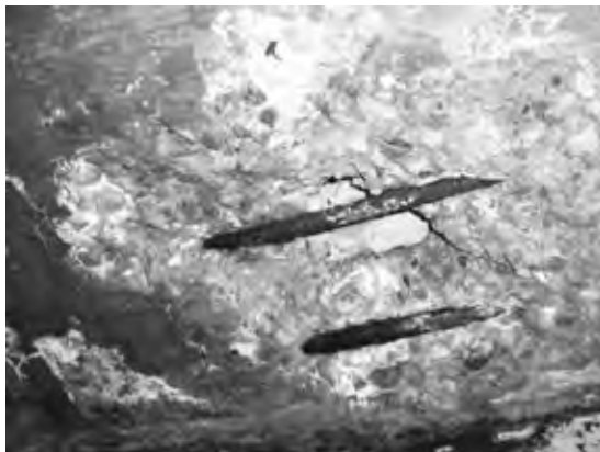
写真—6 床版損傷状況
