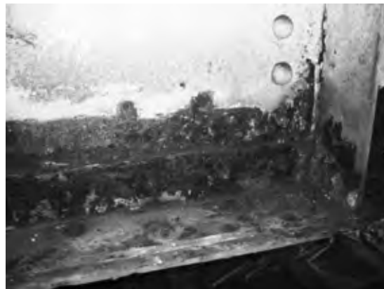
写真—7 鋼材損傷状況
