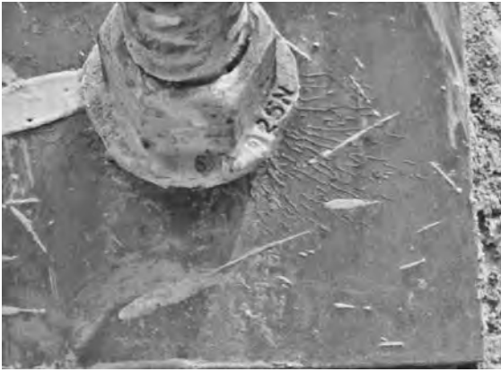
写真一五 変状状況 (プレートの歪み)
