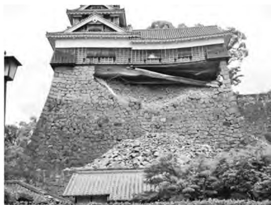
写真—9 南面崩壊後全景（約21%崩落）
