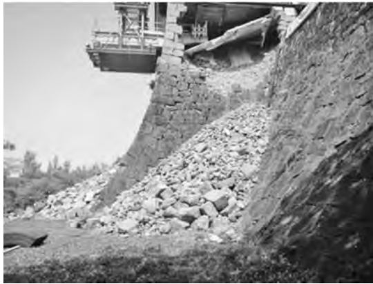
写真—10 東面崩壊後全景 (37% 崩落)
