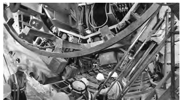
写真-6 No2 台車 内型枠脱型装置
