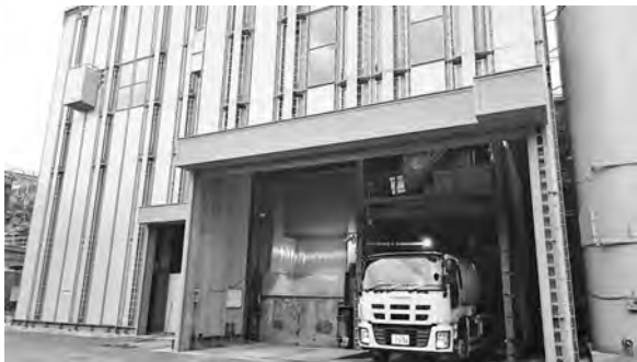
写真七 コンクリート製造設備外観（ヤード奥行きの関係上全景は不可能）
