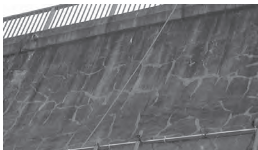
モルタル面のひび割れ
