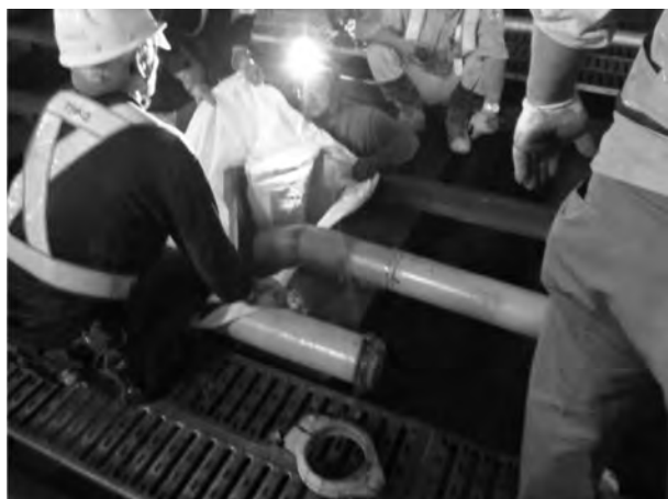
写真—2 ポンプ施工における配管閉塞
