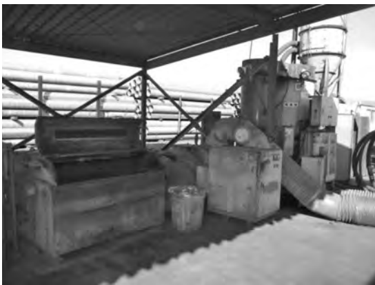
写真-12 集塵機フィルター洗浄機
