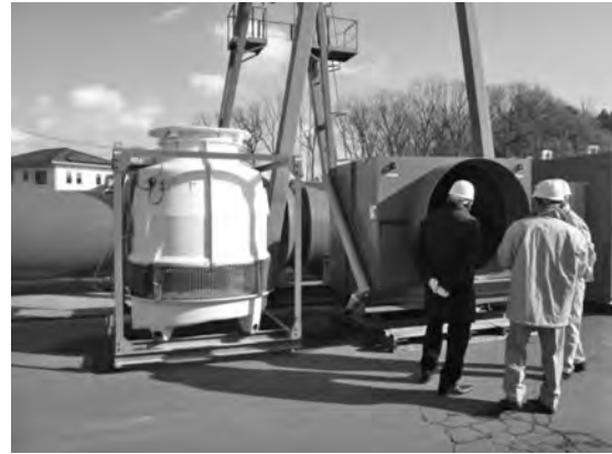
写真-15 トンネルクーラー（左：クーリングタワー、右：ラジエーター）
