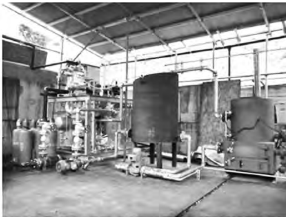
試験機材概観(左から 発電機・貯湯槽・無圧式温水器)
