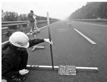
写真一七 わだち掘れ調査
