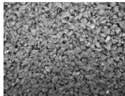
写真一九 路面状況
