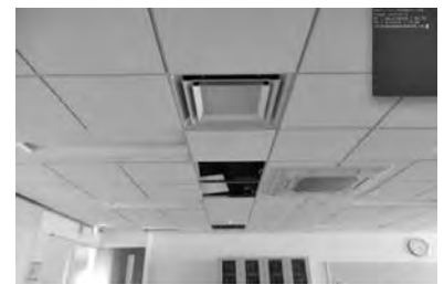
(c) 被害あり (天井材の落下)
