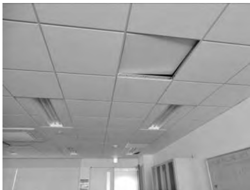
(a) 天井材のずれ
