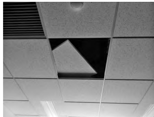
(b) 天井材の落下
