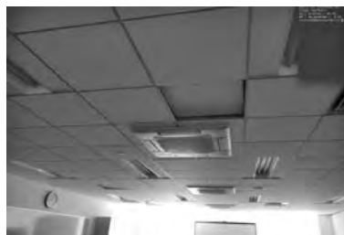
(b) 被害あり (天井材のずれ)
