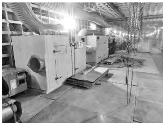
写真— 12 排気浄化装置設置状況
