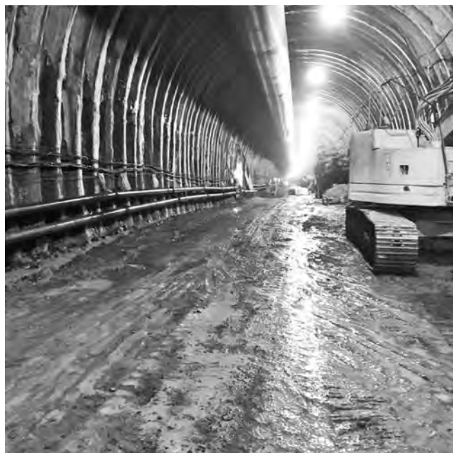
写真—3 トンネルの状況（壁面・底面とも湿潤状態）
