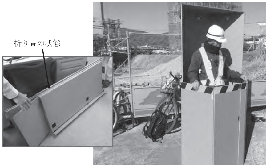
写真-11 紙素材のガードマンボックス利用状況
