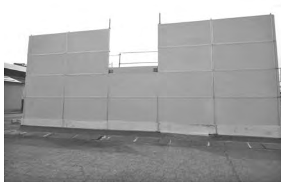
写真一2 設置状況（単独設置）
