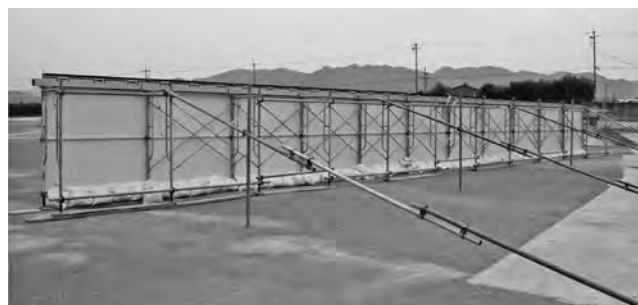
写真―5 背面全景（連続設置）
