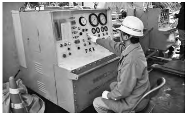
写真-8 全自動油圧ユニット
