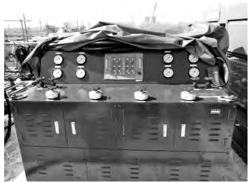
写真-5 電動ポンプユニット
