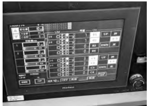
写真-6 集中操作盤
