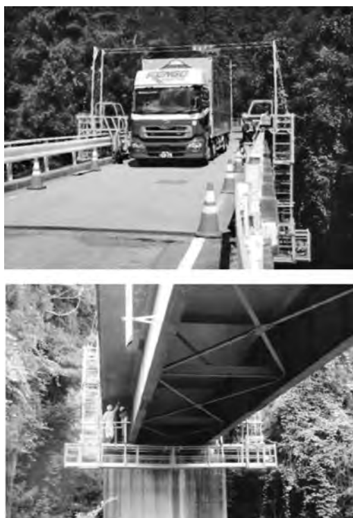
写真一3 N 橋における本装置の状況
