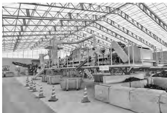
写真—4 解体残渣選別設備
