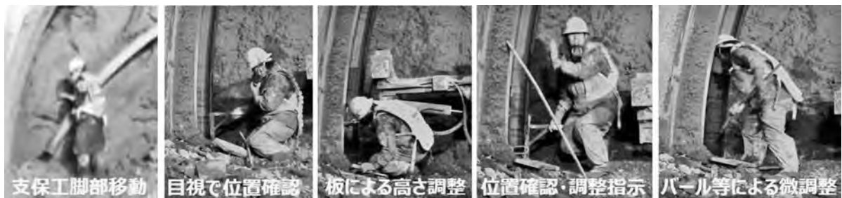
写真一 2 現行の鋼製支保工脚部における作業フロー（切羽左側）
