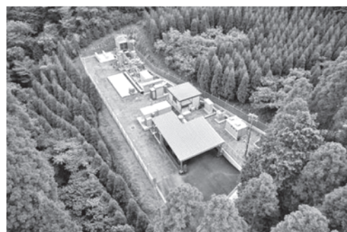
写真-2 グリーン水素製造プラント
