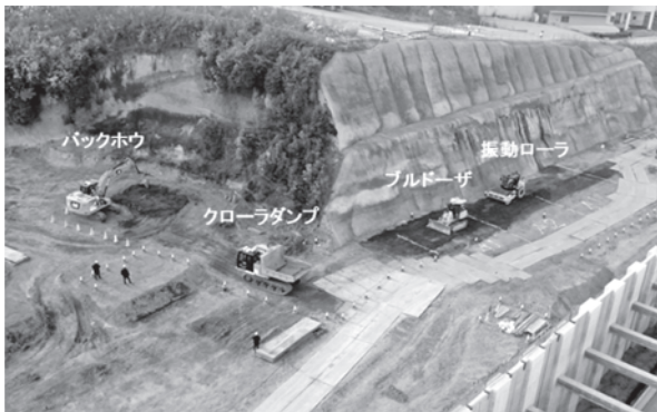
写真—2 協調制御実証実験の状況
