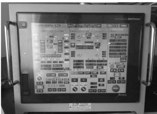
写真一4 刃口制御パネル
