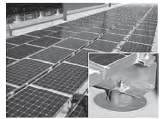
図-13 屋上の太陽光発電パネルと専用ディスクによる架台レス化
