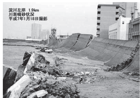
写真-1 地震による液状化で被災した堤防
