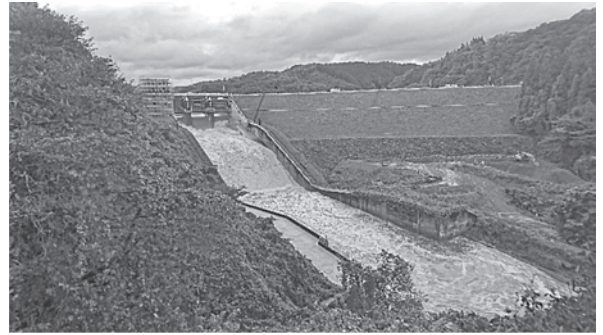
写真一〇 R1年台風19号洪水 放流状況
