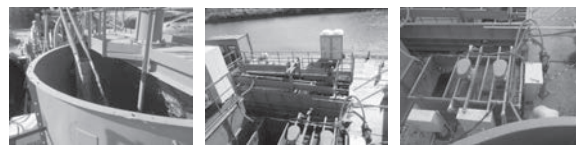
写真一4 細粒分を凝集沈殿処理する水処理設備 ・分級の過程で土砂解泥のために加水（＝湿式分級）を行う ・2次処理後の泥水中の細粒分をPAC+高分子凝集剤（＝水質環境基準適合品）により凝集沈殿させたうえ、循環・再利用（＝水使用量の抑制）
