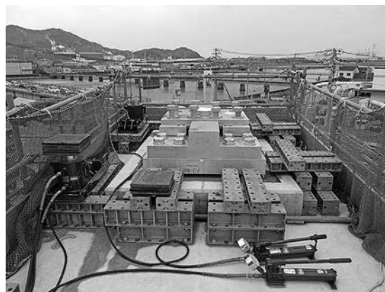
写真-3 P4 支承調整装置および固定装置
