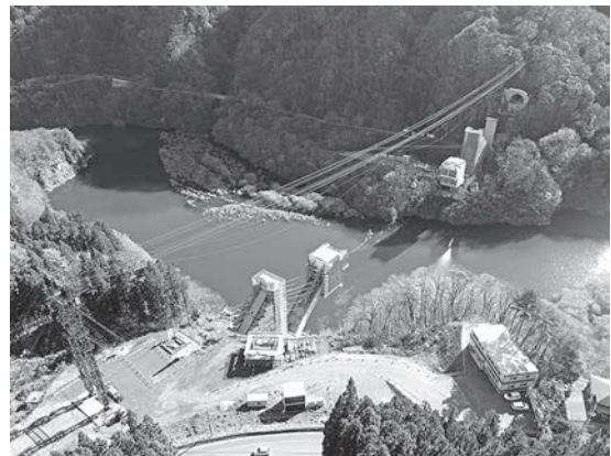
写真-1 ケーブルクレーン全景
